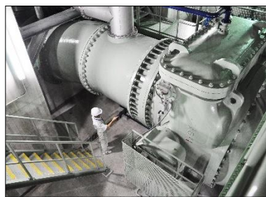
図表5-I 設備の点検状況
