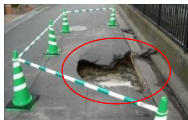
図表1-I 管路の破損による道路陥没例
