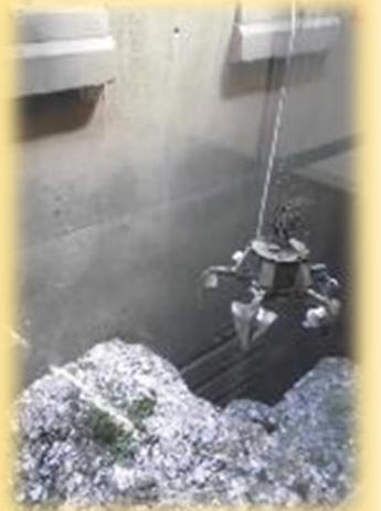
ごみクレーンとごみピット（中工場）
