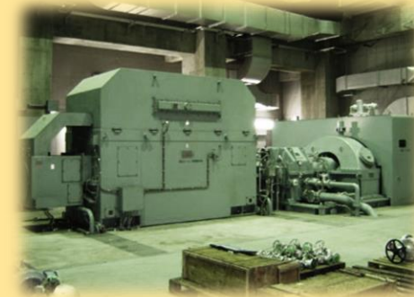
蒸気タービン発電機（中工場）
