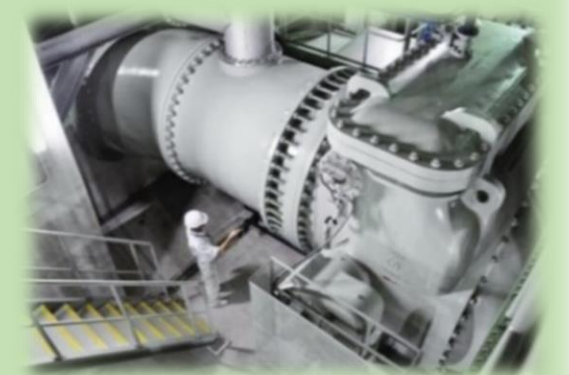
広島市最大の雨水ポンプ（新千田ポンプ場）
