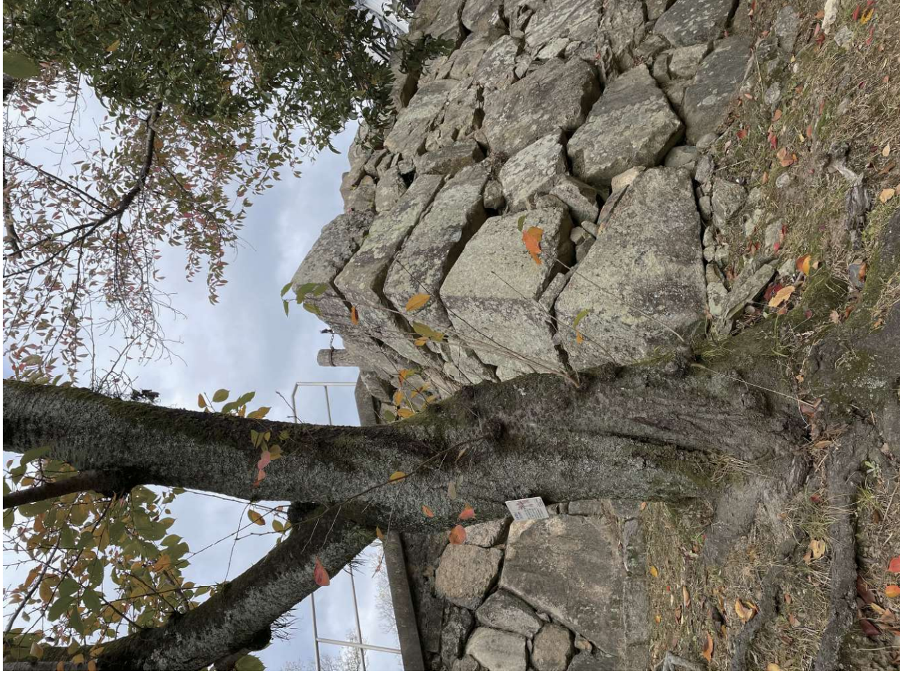
H059 (南小天守台南面) 東側 H059 (南小天守台南面)・H058 (南小天守台東面) 出隅部
