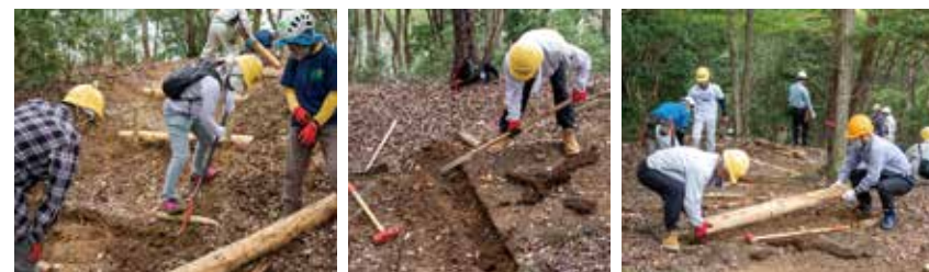
バールで古い横木やクギを撤去。溝を掘って新しい丸太を据えます
