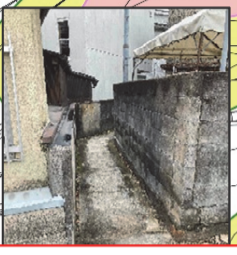
狭い路地。高いブロック 塀の倒壊に注意
