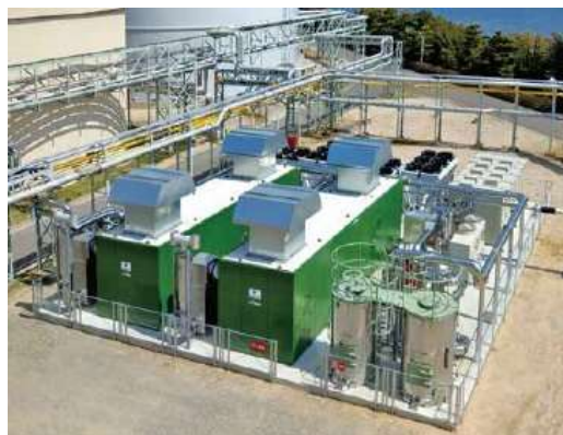
消化ガス発電設備
