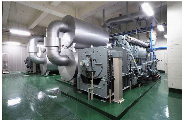
新千田ポンプ場（内部）
