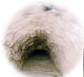
汚れた下水道管
