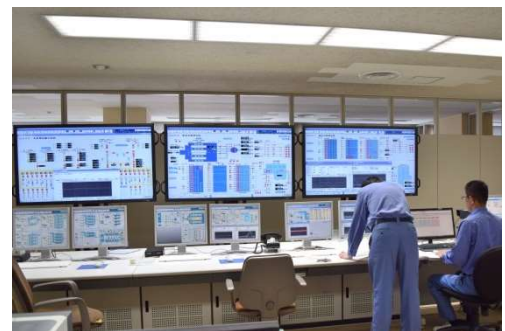
中央管理室での運転管理
