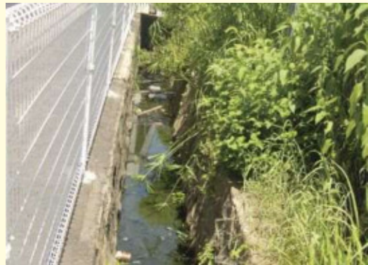
下水道施設が未整備で、衛生上、問題があります。
