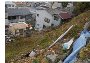
高台から瓦礫や岩石、柵等が落下するおそれ
