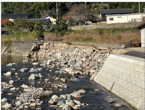
図9 台風による玖島川護岸の被害1
