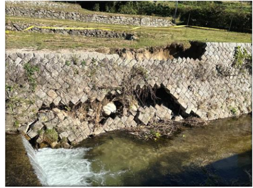
図10 台風による玖島川護岸の被害2
