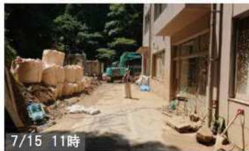
⑯大学施設内の被災状況 大学ホールは土砂が流入し窓 枠が損壊するなど被害が発生
