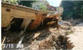
⑧被災した家屋 土石流の影響を一番受けた家 屋は倒壊している
