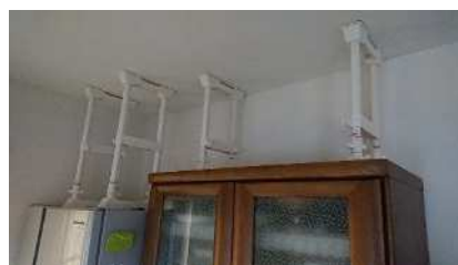
冷蔵庫・食器棚の転倒防止
