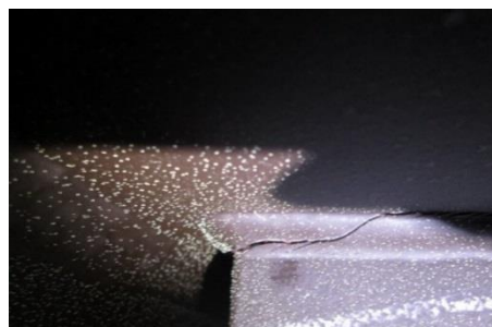
写真 1 鋼製橋脚内部梁上フランジの塗膜割れ (近接目視のみでは鋼材の亀裂が検出できない)
