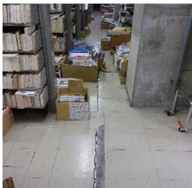
3階書庫床（床の亀裂と床置き書籍）
