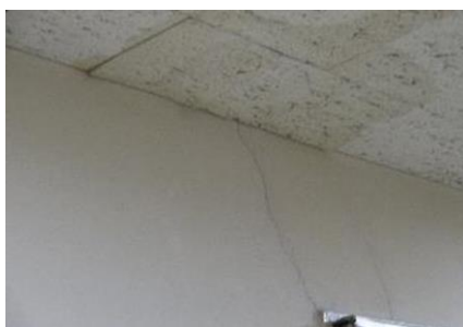
3階セミナー室前倉庫天井（雨漏跡）
