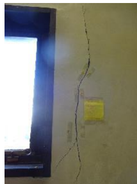
1～2階西側非常用階段壁（亀裂）
