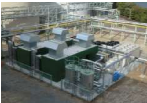
西部水資源再生センター消化ガス発電施設
