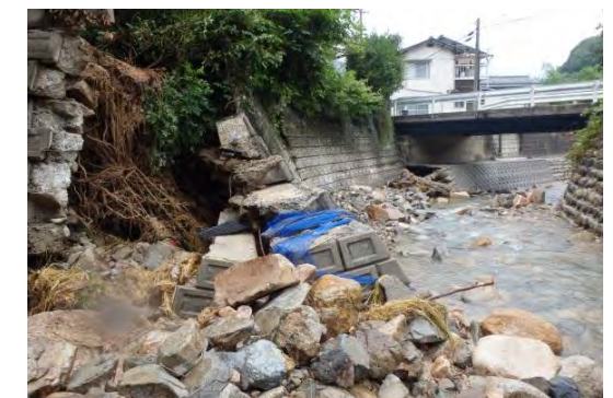
写真 5-17 大林町高谷川の被災護岸 高谷川の増水により石積みの護岸が崩壊しました。
