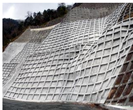
写真 資 5-4 のり枠工の例
