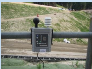
現場設置状況(子機)
