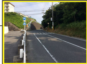
現在、道路（2車線）を整備中。連立事業で整備する東西幹線道路と一体となって、地区の交通の円滑化が期待されます。
