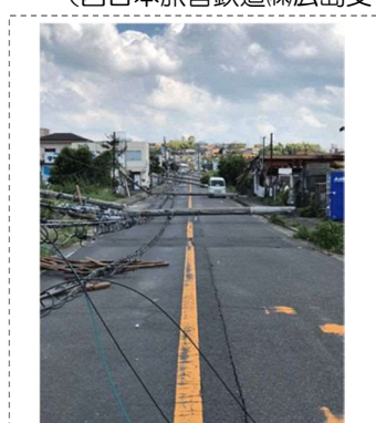
平成30年の台風21号による電柱倒壊 （大阪府泉南市） 〔引用：令和元年版 防災白書（内閣府 HP） http://www.bousai.go.jp/kaigirep/hakusho/h31/photo/ph011.html 〕
