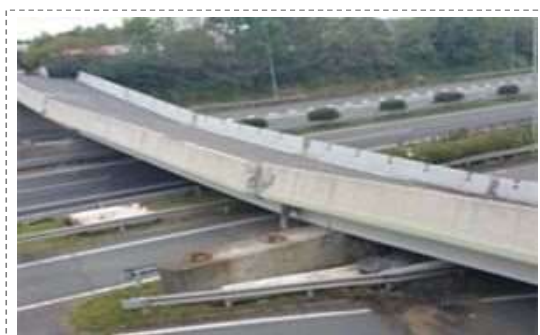
平成28年熊本地震における 九州自動車道を跨ぐ府領第一橋の落橋 〔引用：国土交通省 HP（道路における震災対策） https://www.mlit.go.jp/road/bosai/measures/index1.html 〕
