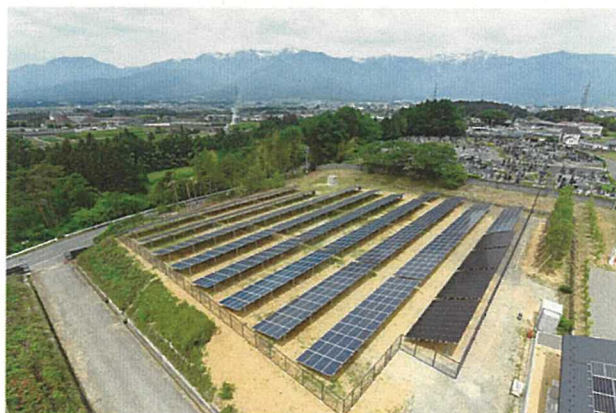
図表 56 リユース品を使用した発電所
