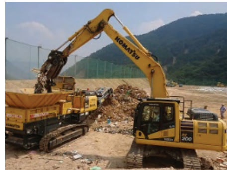
破碎機での処理 (⑥)
