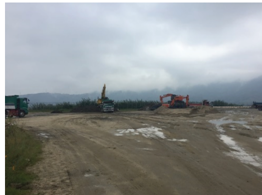
C：場内に点在している土砂（がれき混じり土砂）
