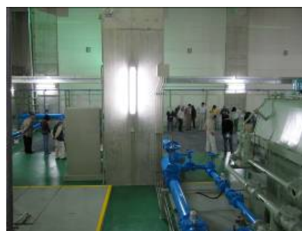
新千田ポンプ場（地下）
