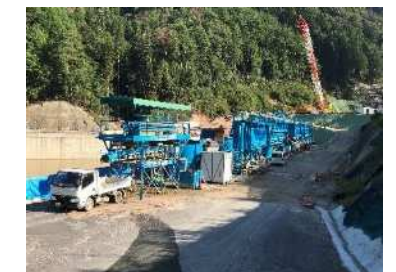
防災調整池南側に濁水処理設備を設置しています。
