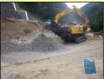
《③岩破碎状況》
