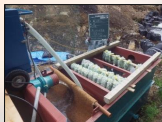
≪モールコード(濁水タンク内)≫
