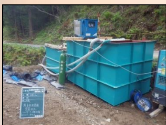
≪濁水処理設備(pH中和装置)≫
