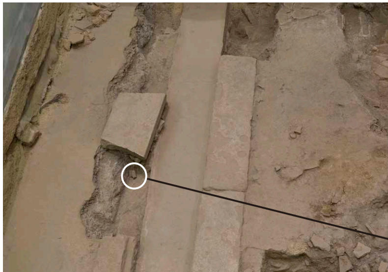
2024/8/15 レンガ片の崩落を確認した。
