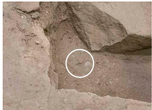
2022/8/24 拡大写真 亀裂が初めて確認された。
