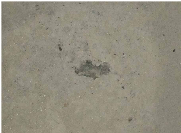
2026/4/13 陥没部分 長辺約 3cm
