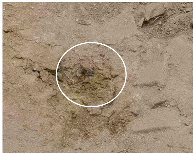
2026/7/15 析出箇所周辺に大きな変化は見られない。 周辺の亀裂については（4）参照。
