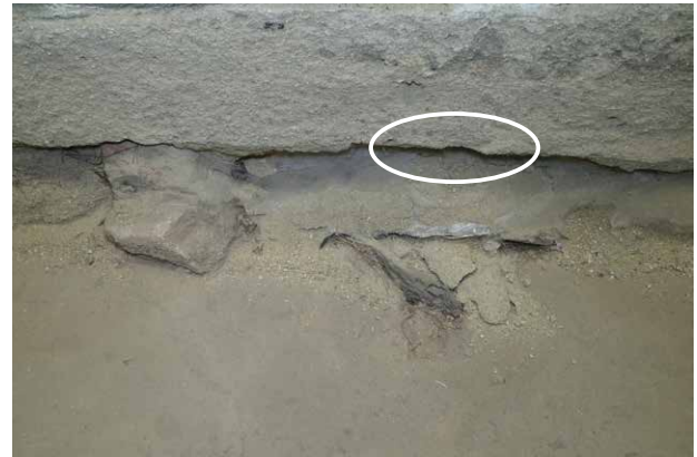
2026/6/15 白丸部分が崩落していた。
