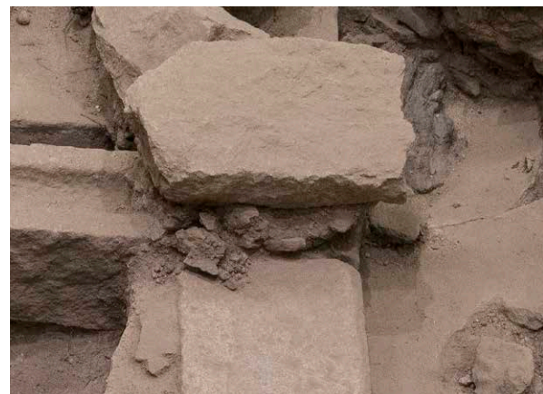
2024/7/16 下層部の土層部分が崩壊した。
