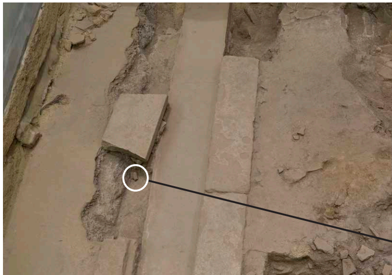
2024/8/15 レンガ片の崩落を確認した。
