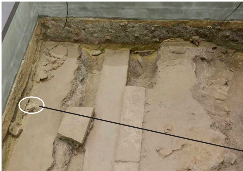
2026/6/15 崩落を確認した。
