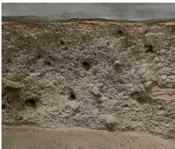
2026/5/15 析出部分 拡大写真①
