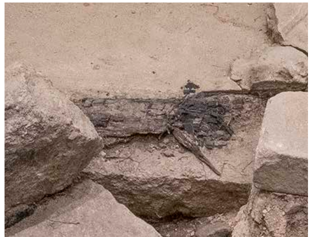
2022/7/14 崩壊箇所が広がる。
