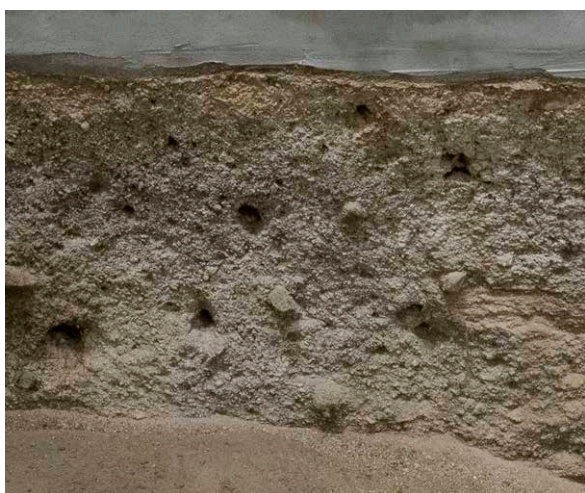
2026/6/15 析出部分 拡大写真①
