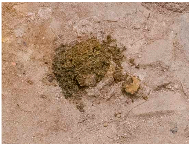
2022/10/13 析出した状況。
