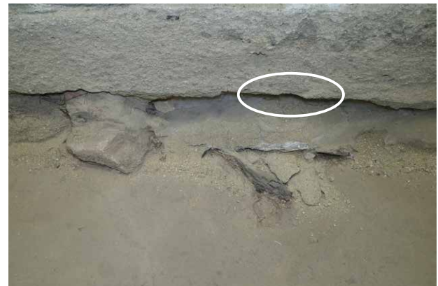
2026/6/15 白丸部分が消失していた。
