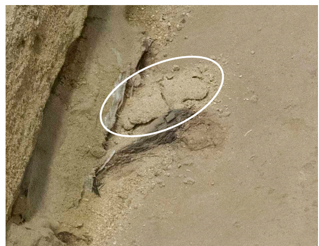
2026/6/15 白丸部分が崩落していた。
