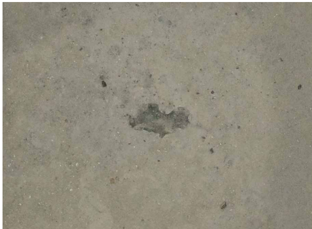
2026/4/13 陥没部分 長辺約 3cm
