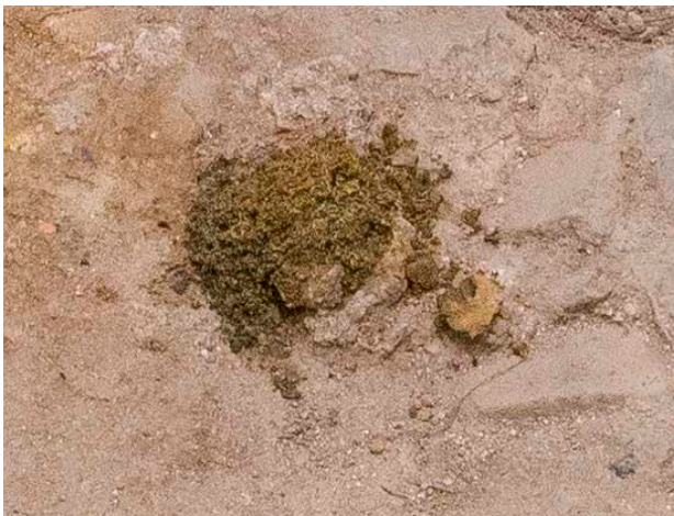
2022/10/13 析出した状況。
