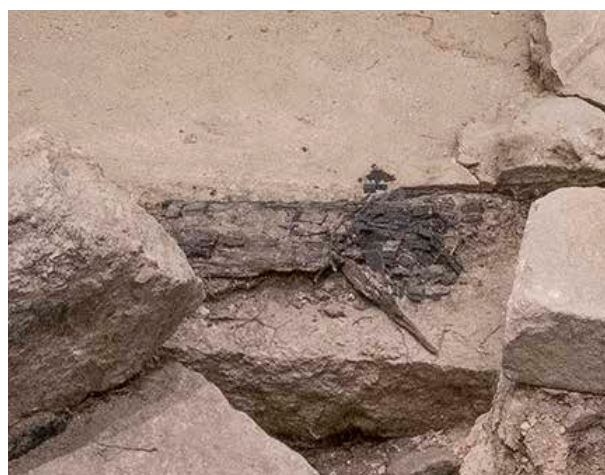
2022/7/14 崩壊箇所が広がる。
