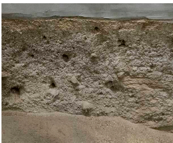
2026/4/13 析出部分 拡大写真①
