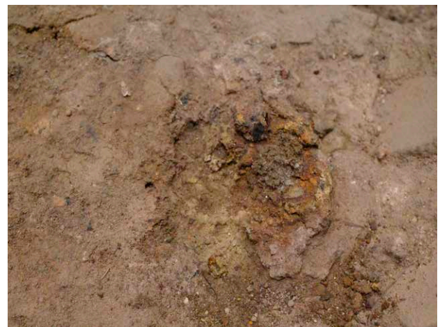
2023/9/14 析出物除去後の様子。
