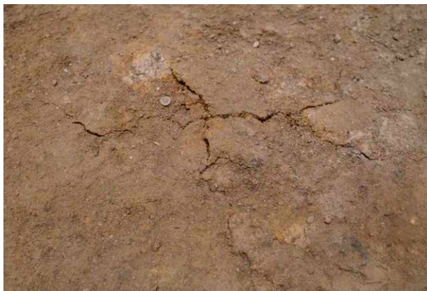
2023/4/24 亀裂 縦約 5.4cm 横約 12.6cm
