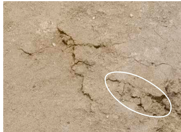
2026/5/15 亀裂 縦約 13.0cm 横約 25.0cm (先月 縦約 13.0cm 横約 25.0cm) 亀裂部分に風化が見られる。
