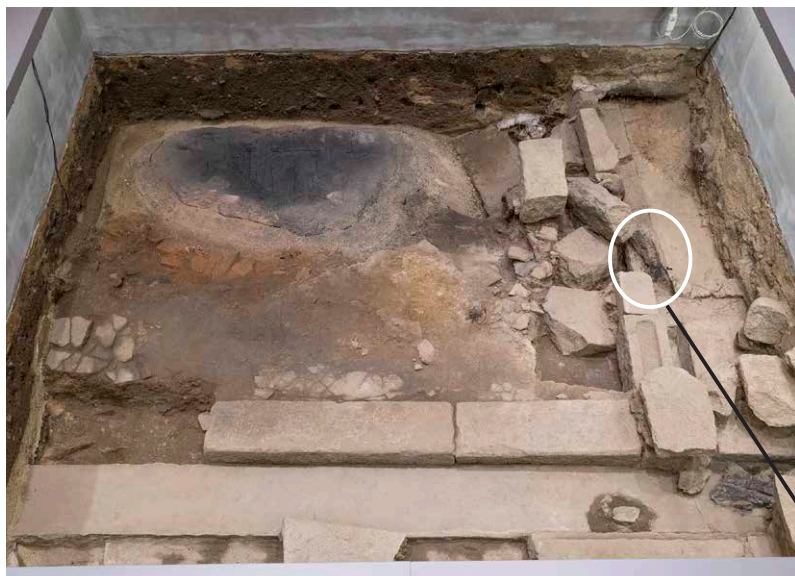
2022/5/16 崩壊を確認した。
