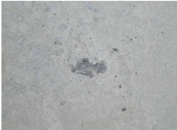
2026/4/13 陥没部分 長辺約 3cm
