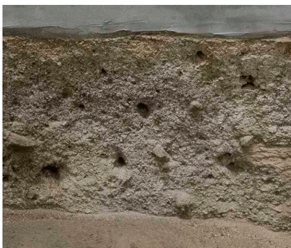
2026/5/15 析出部分 拡大写真①
