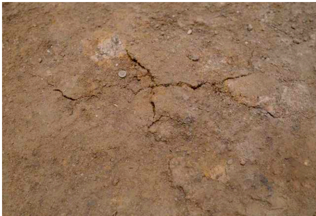
2023/4/24 亀裂 縦約 5.4cm 横約 12.6cm
