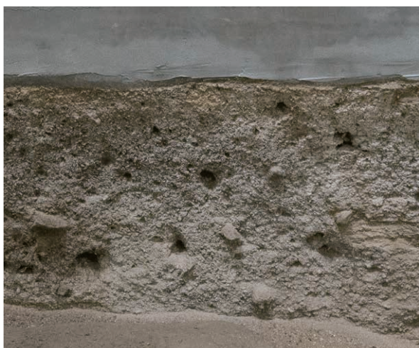
2026/3/10 析出部分 拡大写真①
