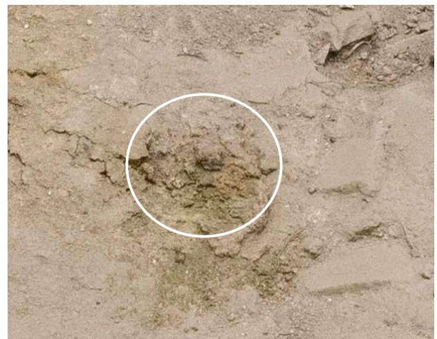
2026/4/13 析出箇所周辺に大きな変化は見られない。 周辺の亀裂については（4）参照。
