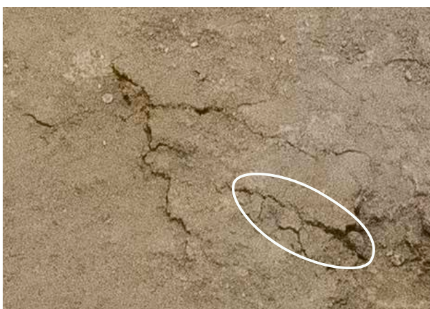
2025/4/18 亀裂 縦約 12.2cm 横約 24.5cm 白丸部分の亀裂が広がり、亀裂発生前（2022年4月時点）と比べて約2.1cm盛り上がっている。
