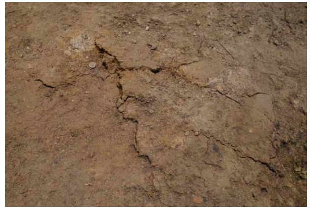
2024/2/15 亀裂 縦約 11.4cm 横約 19.6cm 亀裂が硫酸塩が析出した場所まで広がっている。
