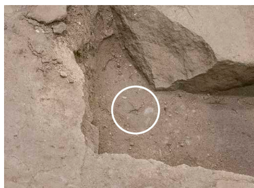
2022/8/24 拡大写真 亀裂が初めて確認された。
