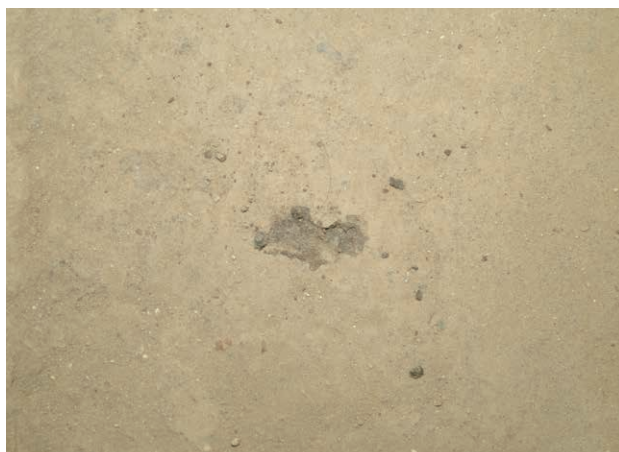
2026/3/10 陥没部分 長辺約 3cm
