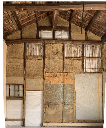
図 5-改善する壁の現状
