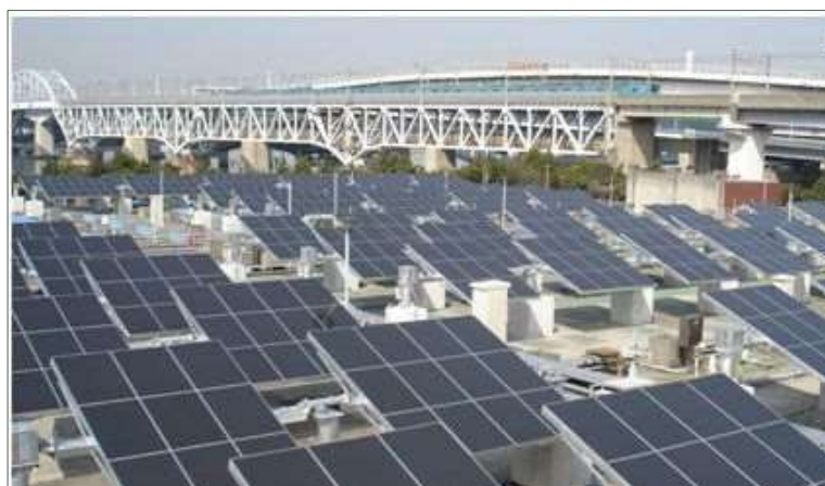
写真-11 下水道施設（処理場）の屋上に設置した太陽光発電の例
