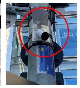
▲設置した防犯カメラ
