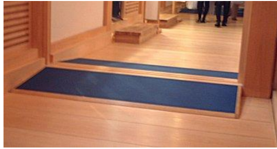
写真 2-12 スロープ設置例 (熊本城本丸御殿)
