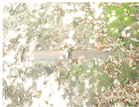
写真 10-2 雨水排水管の露出
