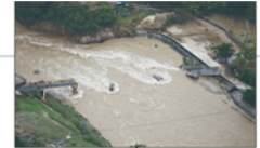
第1三篠川橋りょうの流出（白木山～狩留家）
