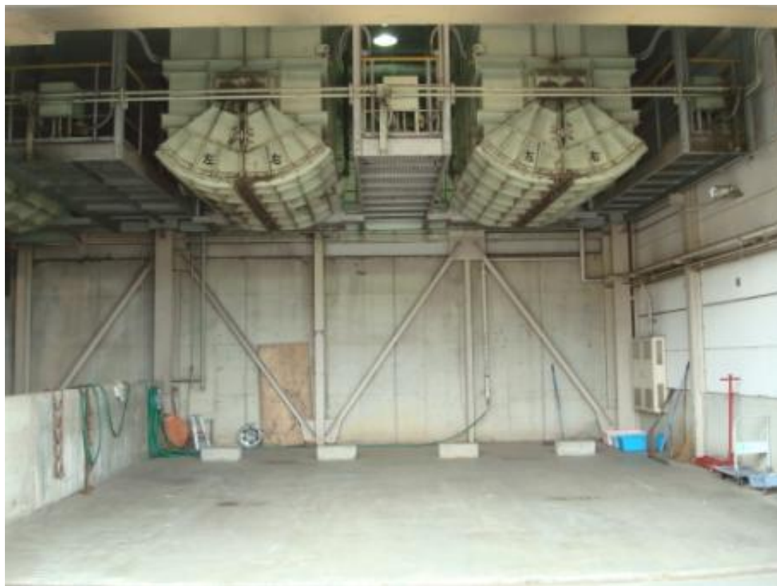
（貯留搬出室貯留ホッパー）
