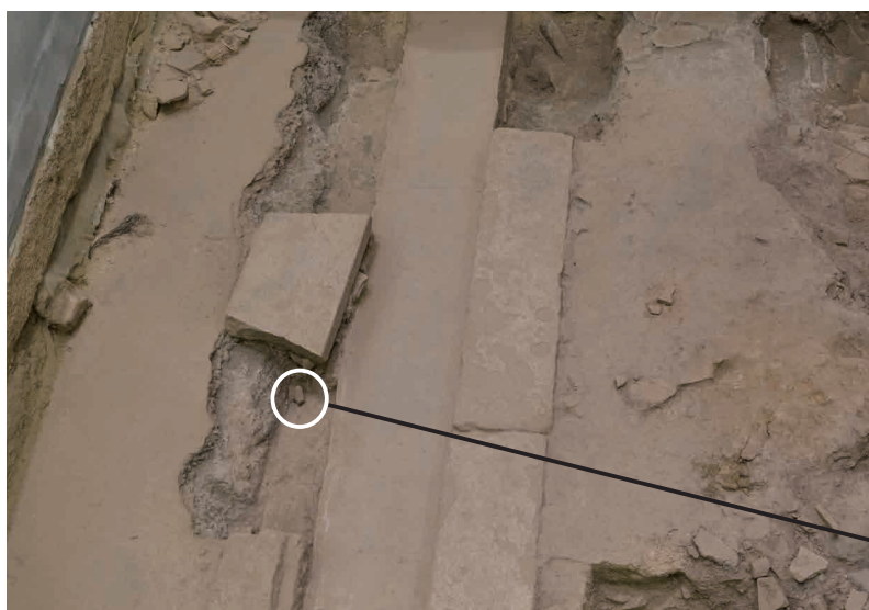
2024/8/15 レンガ片の崩落を確認した。
