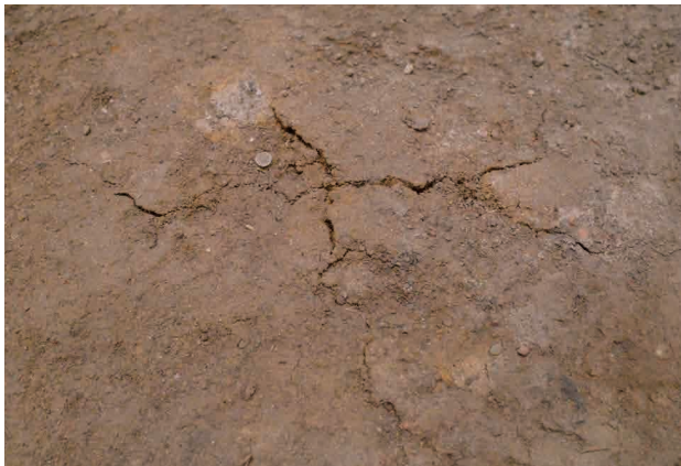
2023/4/24 亀裂 縦約 5.4cm 横約 12.6cm
