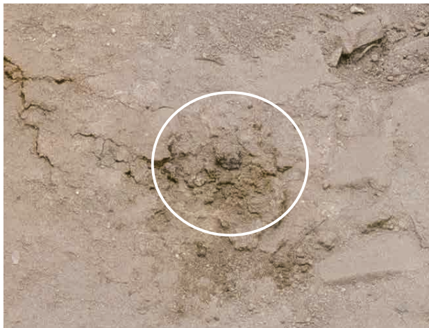
2025/9/16 析出箇所周辺に大きな変化は見られない。 周辺の亀裂については（4）参照。
