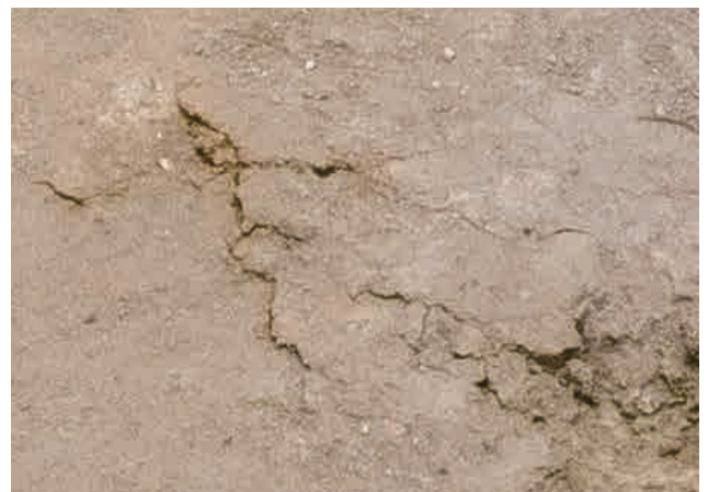
2025/9/16 亀裂 縦約 12.4cm 横約 24.8cm 亀裂及び表層の隆起は、わずかに進行している。
