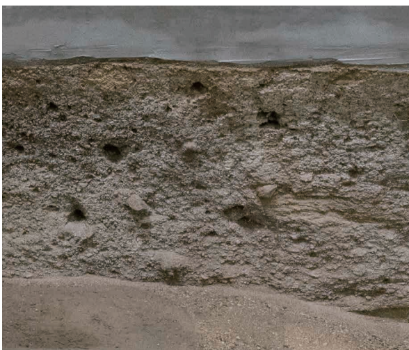
2025/8/12 析出部分 拡大写真①
