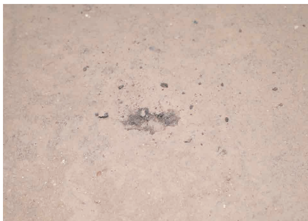
2025/4/18 陥没部分 長辺約 3cm
