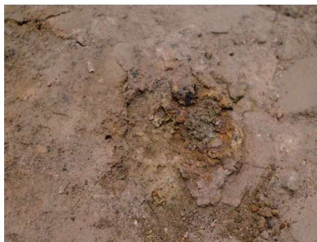
2023/9/14 析出物除去後の様子。
