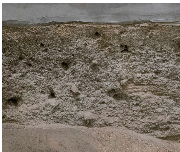
2025/9/16 析出部分 拡大写真①
