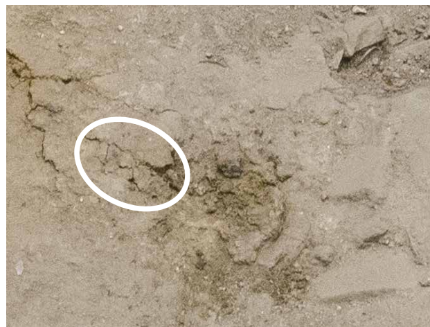
2025/8/12 析出物に大きな変化は見られない。 周辺の亀裂については（4）参照。
