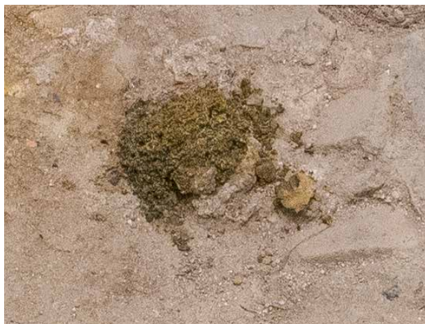
2022/10/13 析出した状況。
