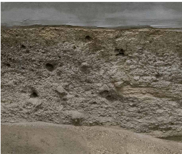
2025/8/12 析出部分 拡大写真①
