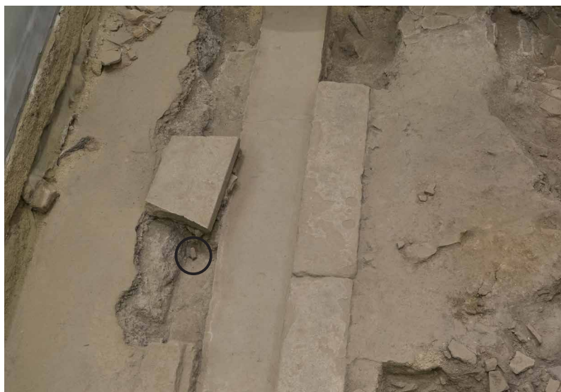
2024/8/15 レンガ片の崩落を確認した。
