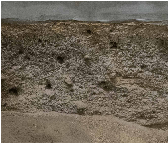
2025/7/15 析出部分 拡大写真①
