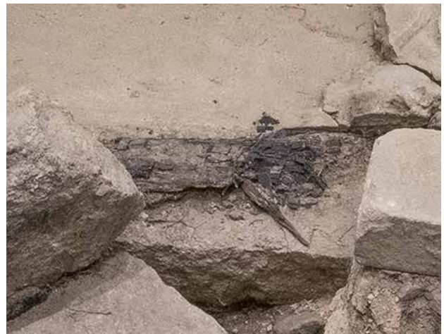
2022/7/14 崩壊箇所が広がる。
