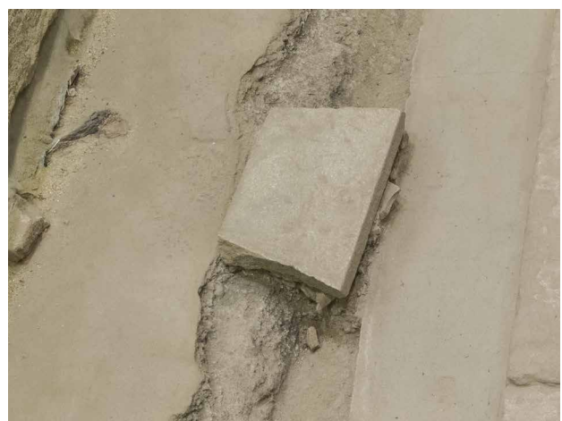
2025/7/15 崩落後から変化は見られない。
