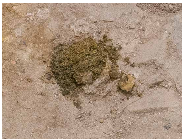
2022/10/13 析出した状況。
