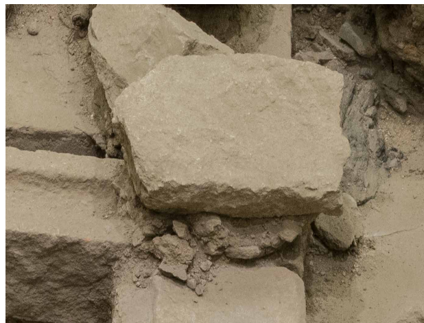
2025/7/15 崩壊後から変化は見られない。
