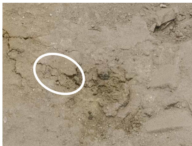
2025/7/15 析出物に大きな変化は見られない。 周辺の亀裂が広がっている。((4) 参照)
