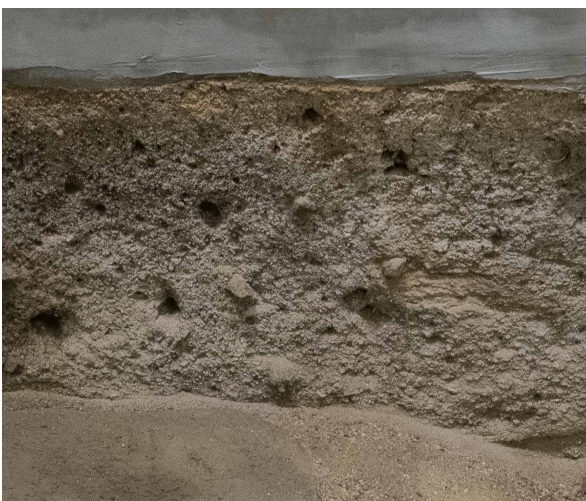
2025/7/15 析出部分 拡大写真①
