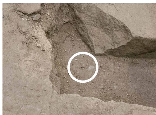
2022/8/24 拡大写真 亀裂が初めて確認された。
