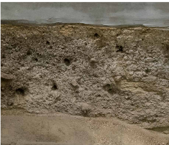
2025/6/11 析出部分 拡大写真①
