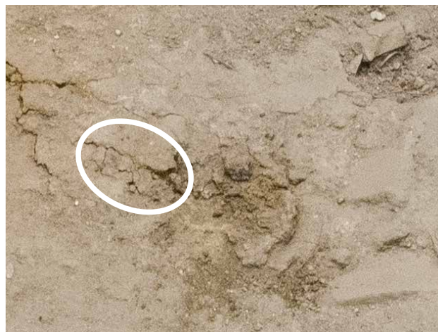
2025/5/19 析出物に大きな変化は見られない。 周辺の亀裂が広がっている。((3) 参照)
