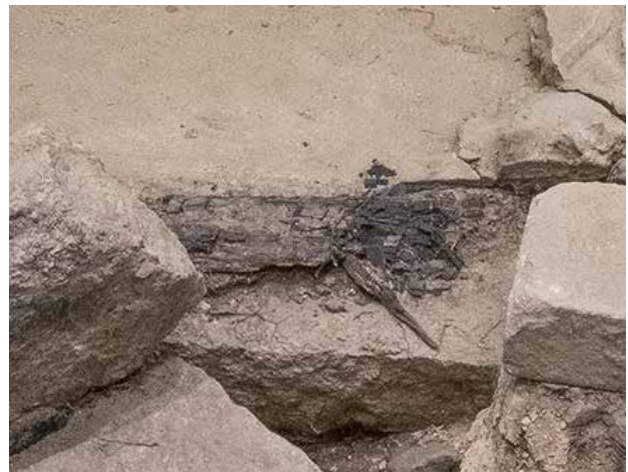
2022/7/14 崩壊箇所が広がる。
