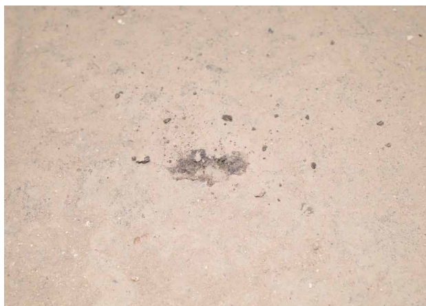
2025/4/18 陥没部分 長辺約 3cm
