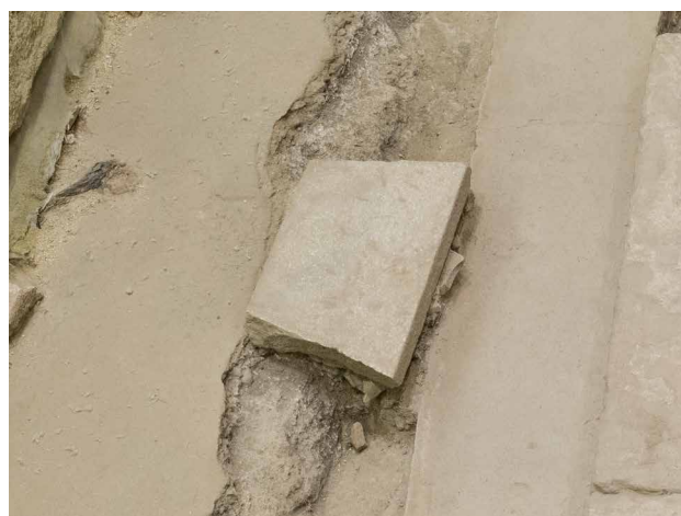
2025/5/19 崩落後から変化は見られない。
