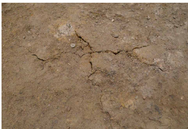
2023/4/24 亀裂 縦約 5.4cm 横約 12.6cm
