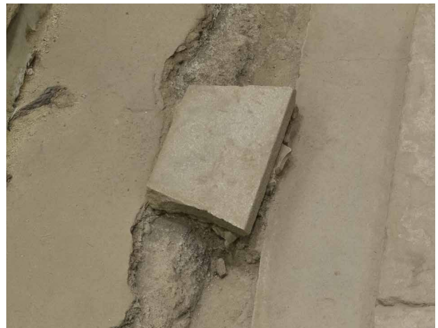
2025/4/18 崩落後から変化は見られない。
