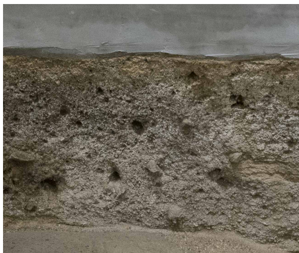
2025/4/18 析出部分 拡大写真①
