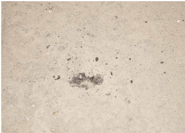
2025/3/14 陥没部分 長辺約 3cm
