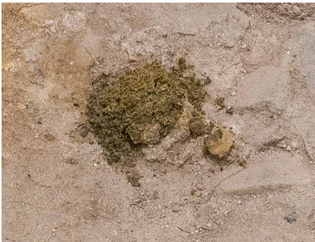
2022/10/13 析出した状況
