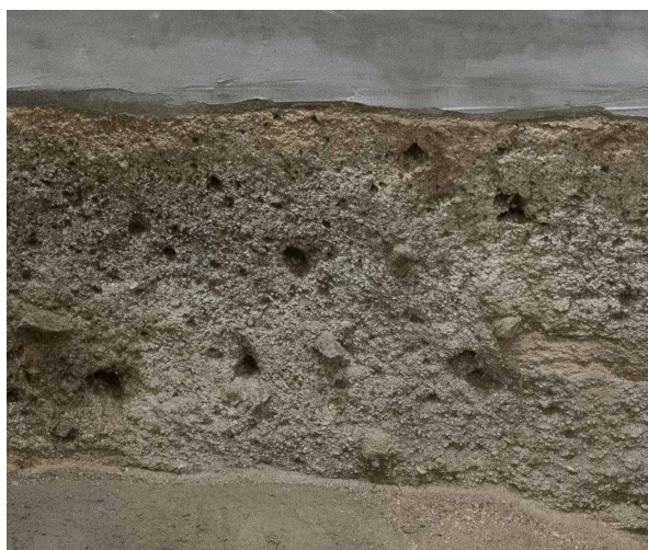
2025/3/14 析出部分 拡大写真①
