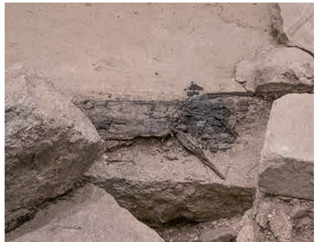
2022/7/14 崩壊箇所が広がる。
