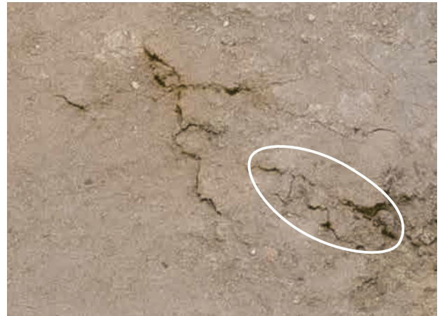
2025/12/16 亀裂 縦約 12.5cm 横約 24.8cm (先月 縦約 12.5cm 横約 24.8cm) 亀裂及び表層の隆起は、先月から変化が見られない。
