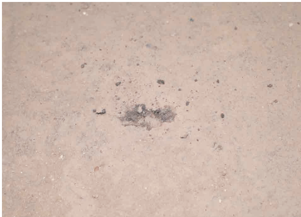
2025/4/18 陥没部分 長辺約 3cm
