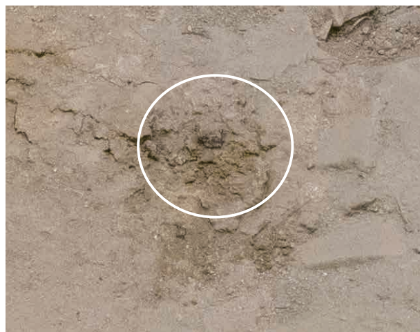
2025/12/16 析出箇所周辺に大きな変化は見られない。 周辺の亀裂については（4）参照。
