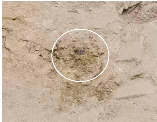
2025/11/18 析出箇所周辺に大きな変化は見られない。 周辺の亀裂については（4）参照。
