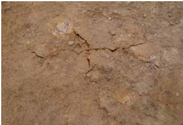
2023/4/24 亀裂 縦約 5.4cm 横約 12.6cm
