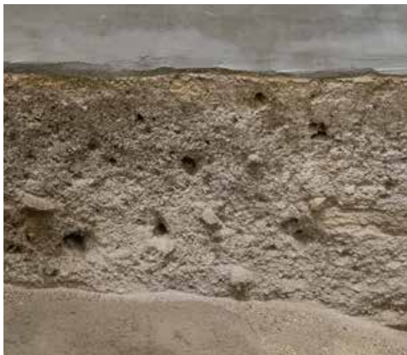
2025/11/18 析出部分 拡大写真①
