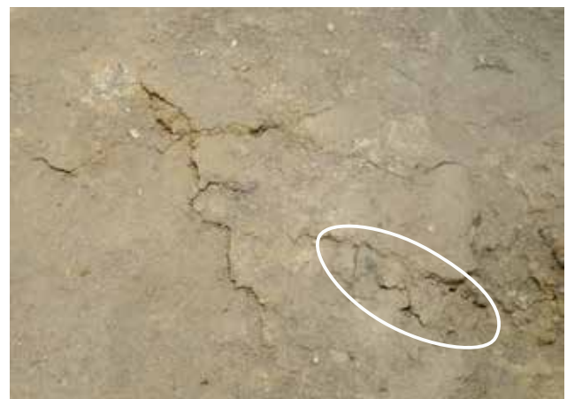
2025/11/18 亀裂 縦約 12.5cm 横約 24.8cm 亀裂及び表層の隆起は、わずかに進行している。
