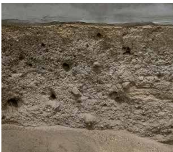
2025/10/15 析出部分 拡大写真①
