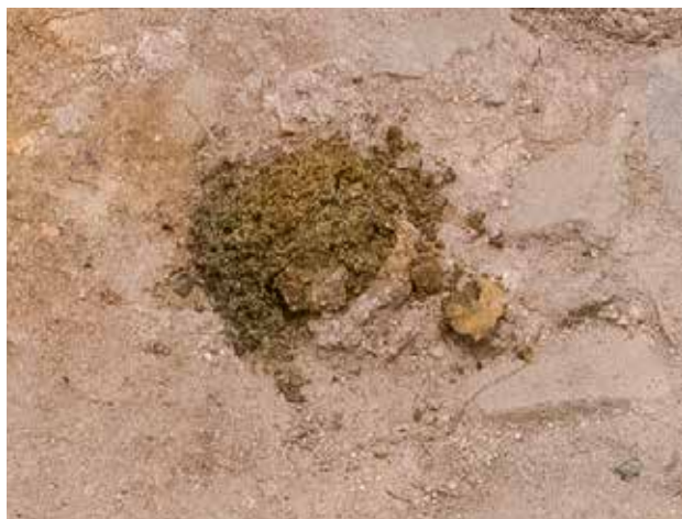
2022/10/13 析出した状況。
