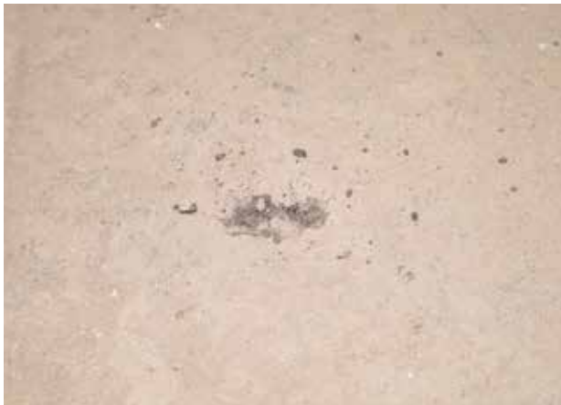
2025/4/18 陥没部分 長辺約 3cm
