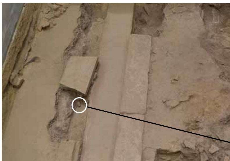
2024/8/15 レンガ片の崩落を確認した。
