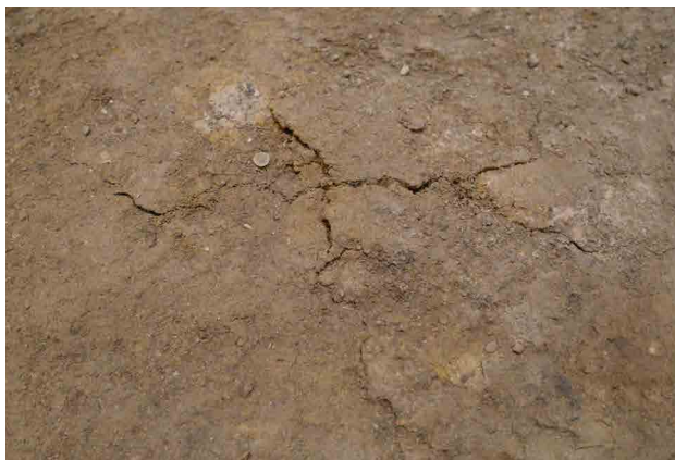
2023/4/24 亀裂 縦約 5.4cm 横約 12.6cm
