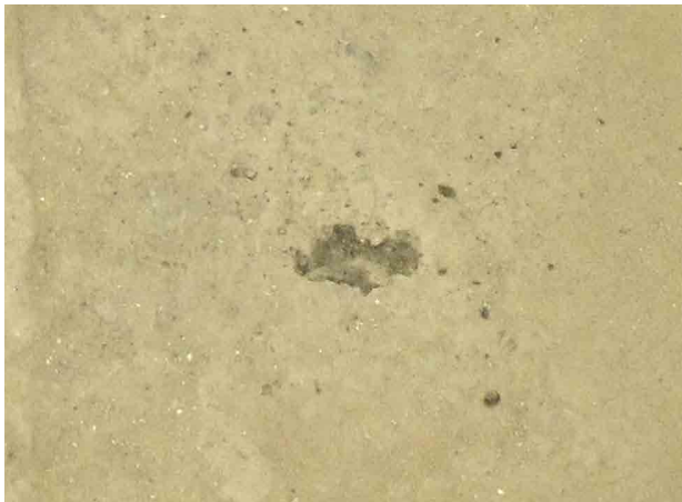
2026/2/16 陥没部分 長辺約 3cm
