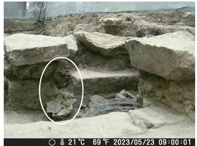
2023/5/23 定点カメラ画像 石列下層部の土層部分が崩壊している。
