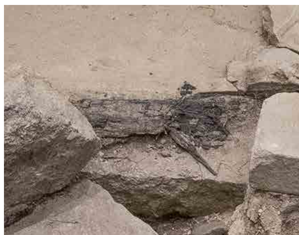
2022/7/14 崩壊箇所が広がる。
