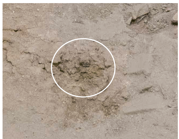
2026/3/10 析出箇所周辺に大きな変化は見られない。 周辺の亀裂については（4）参照。
