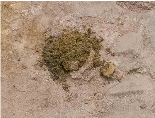
2022/10/13 析出した状況。
