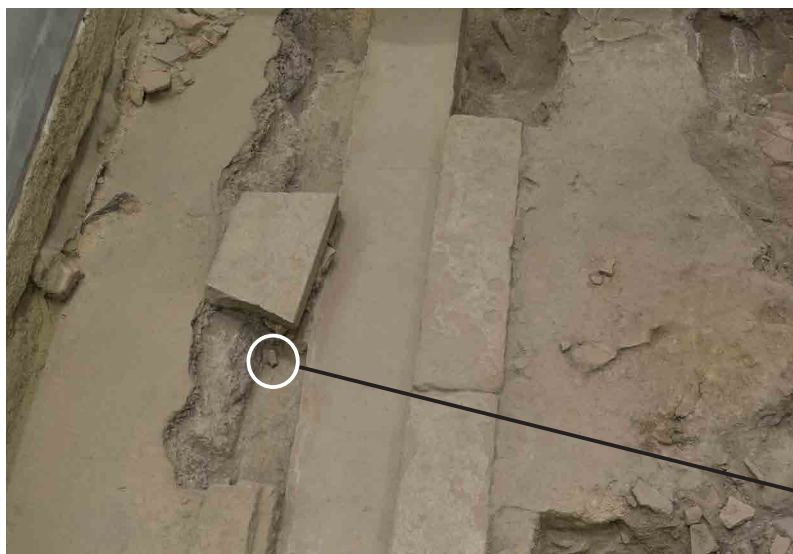
2024/8/15 レンガ片の崩落を確認した。
