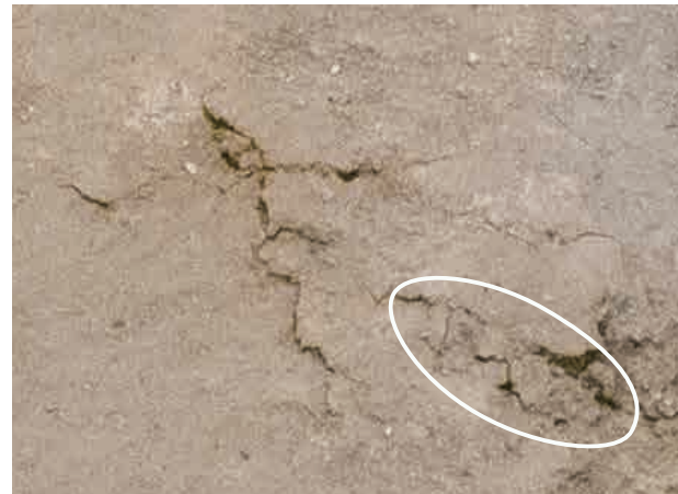
2026/3/10 亀裂 縦約 13.0cm 横約 24.9cm (先月 縦約 12.9cm 横約 24.9cm) 亀裂部分に風化が見られる。
