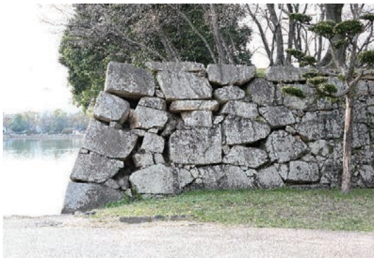
中御門跡の石垣変位状況
