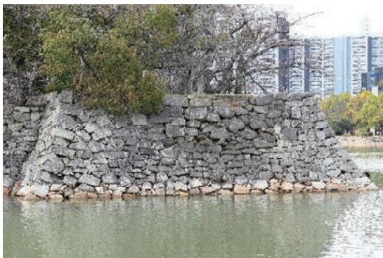
石垣上樹木による石垣変状
