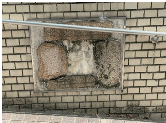
城外展示の劣化
