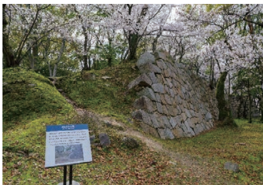
[8] 東側石垣東端に見られる破却痕跡
