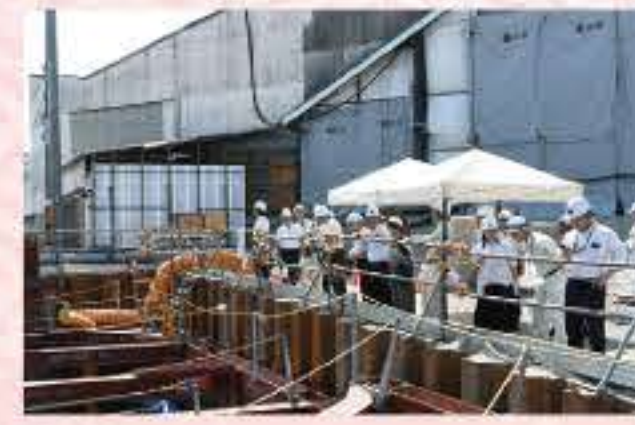
観音地区下水道築造3-1号工事に伴う道路陥没事故現場視察(8/1)
