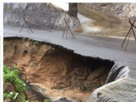
道路が河川侵食
