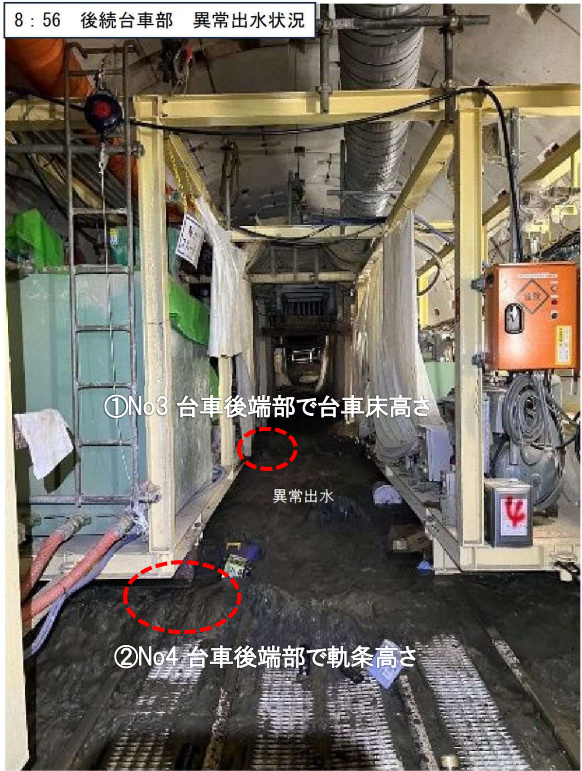
図 4.2 後続台車部出水状況
