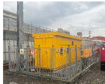
高圧受電設備
